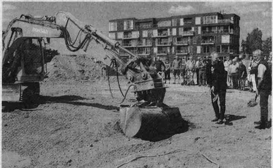
Første spadestik til boligbyggeri på Sophieholmen 6-8 - i gravkoen anes borgmester John Brædder (G) - med spader i hænderne ses Claus Sivager (i midten) og Robert Madsen.
